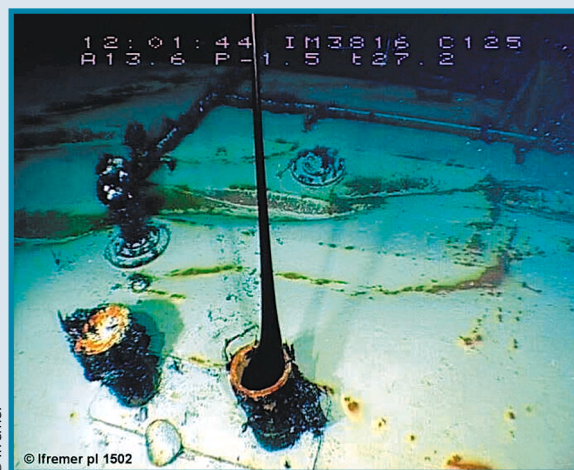
Fuite de la partie avant, sur le pont du Prestige .
